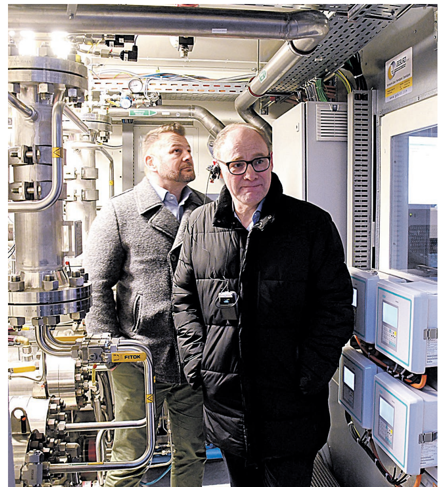
Zum Programm gehört hat auch eine Besichtigung der ESI-Plattform mit Elektrolyseuren.
